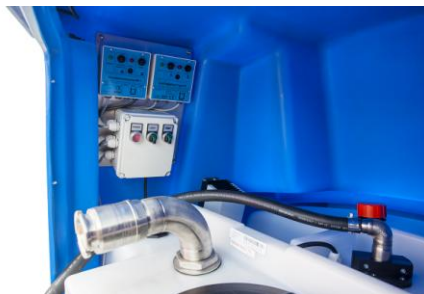
Indicateur de niveau analogique dans une cuve de 2.500 l
