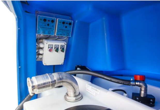
Füllleitung im 2500-l-Tank
