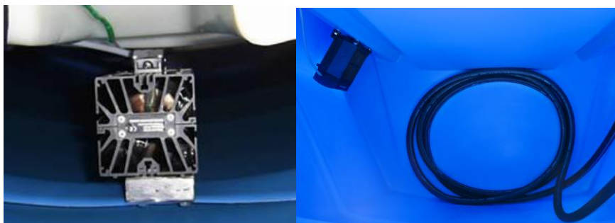
Tankheizung im Tankwall (475 W) und im Abgabegehäuse (950 W).
