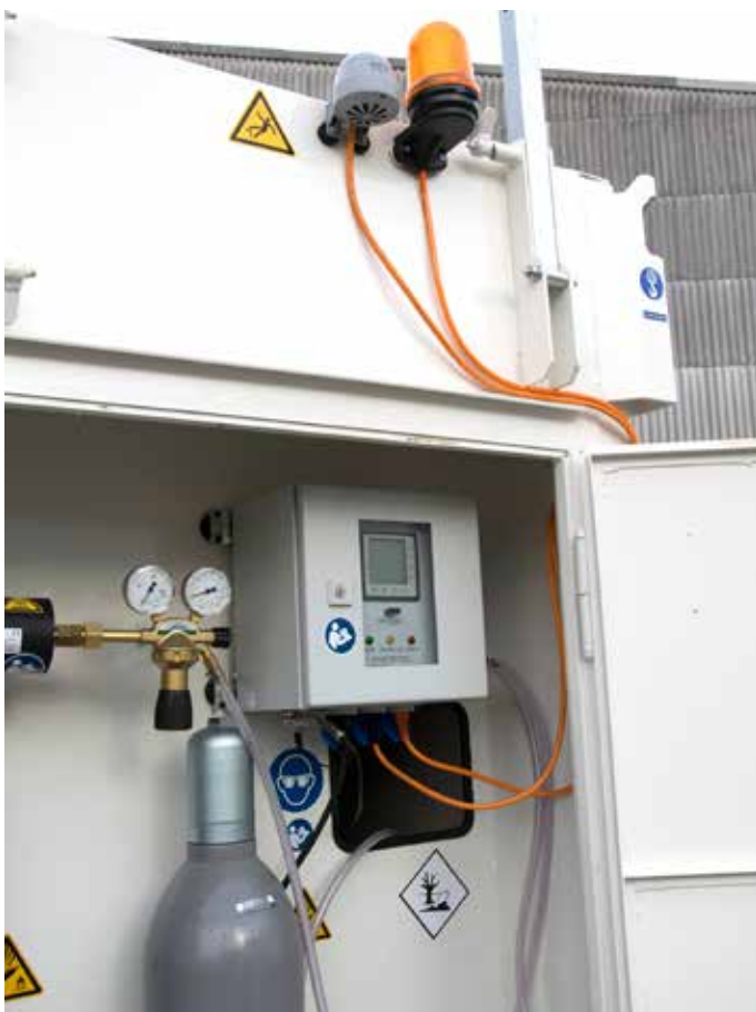
Die von uns entwickelte Alarmvorrichtung enthält Anschlüsse für eine gelbe Rundumleuchte, einen akustischen Alarm sowie eine SMS-Alarmierung
